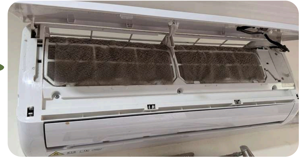
Actual Installation in Indian Homes
